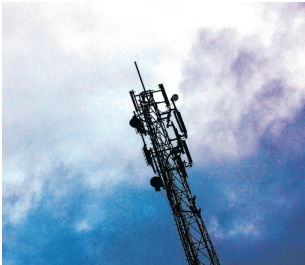
Die Strahlung von Mobilfunkantennen wird kontrovers diskutiert.
